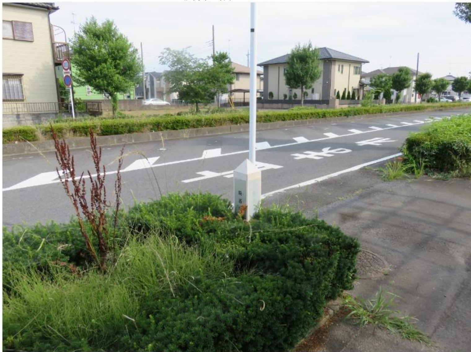
植樹帯に標柱が埋もれている
