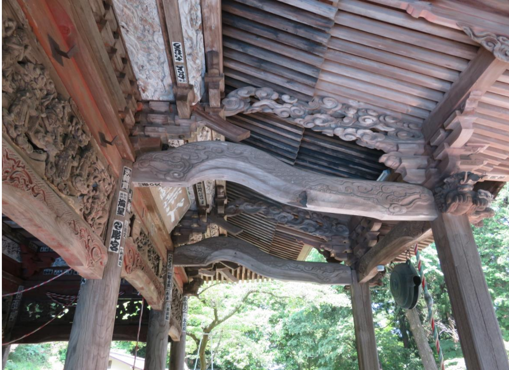
向拝の屋根下を左手から見たところ/海老虹梁や手挟み・木鼻の状況
