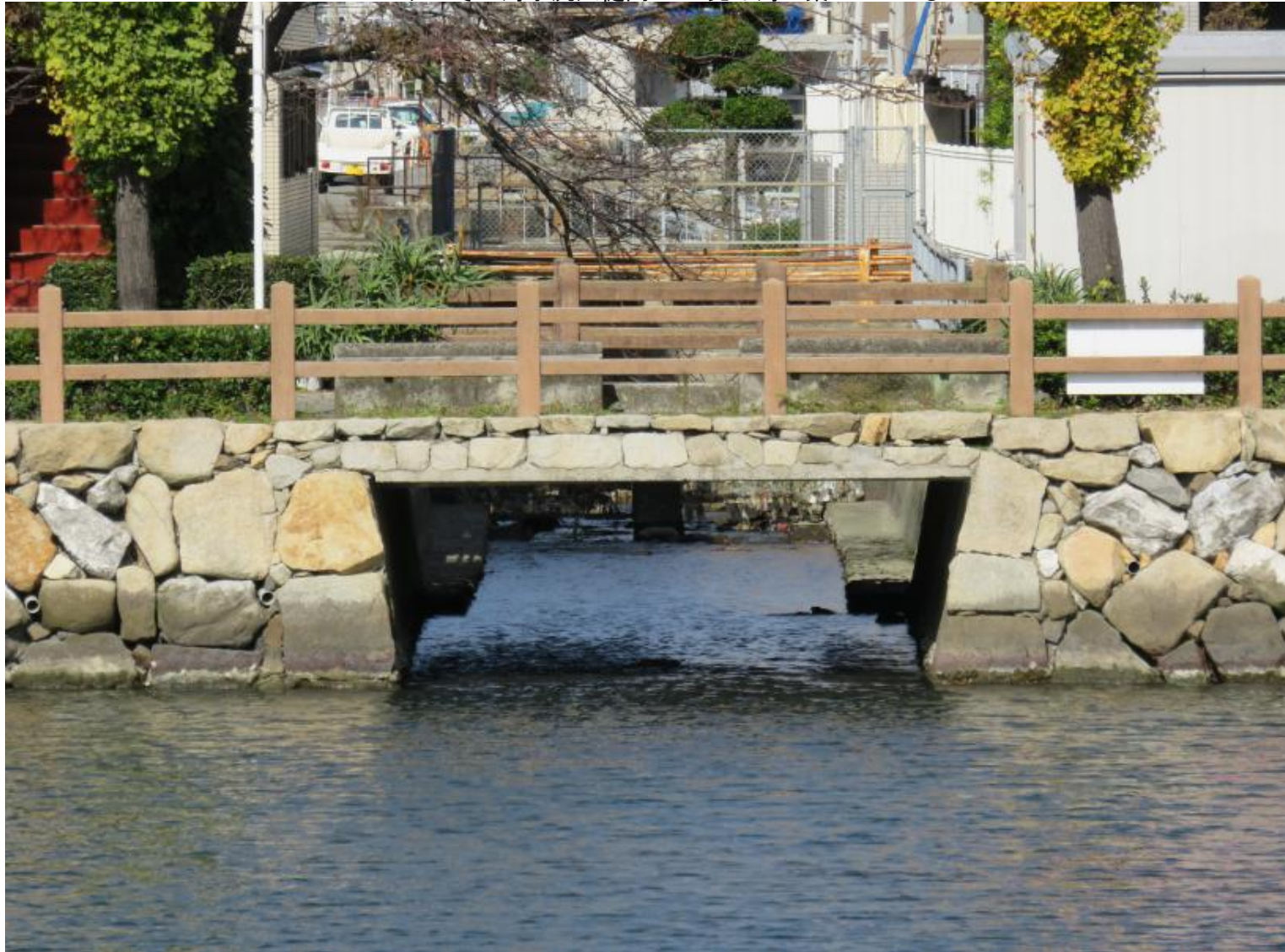
これがその海水流入樋門/この先は海に繋がっている
