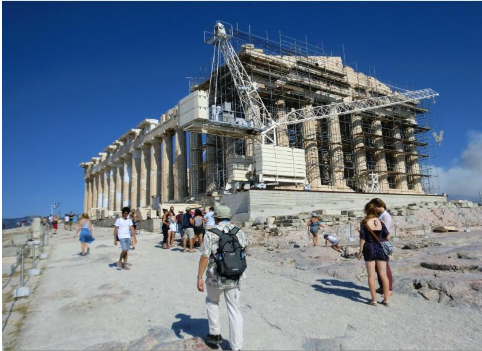
少し近づいて見たところ/西面は足場が架かって工事中
