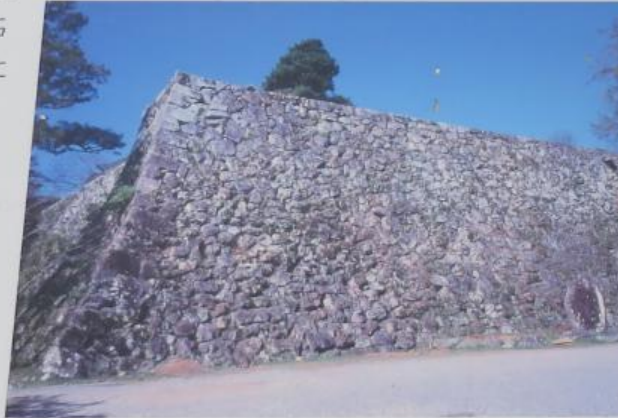
石垣解体前の三ノ丸石垣は、孕みや隅角部の築石にヒビ割れがはいる
