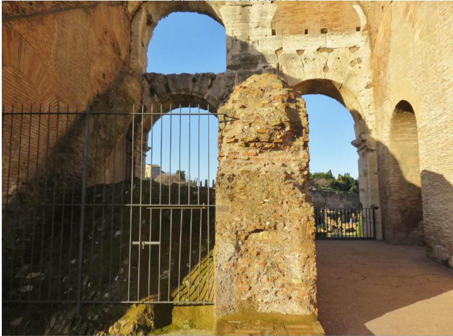
躯体が削られている部分も見られる
